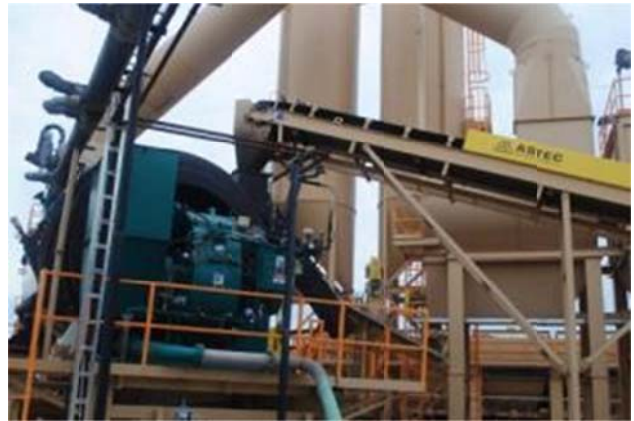
(d) RAP/RAS entrance in drum
